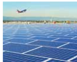
アメリカ カリフォルニア州 サンノゼ 製品名 CS5P システム容量1.12MWp 竣工 2010年6月
